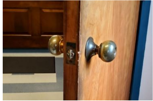
Noncompliant door handles
